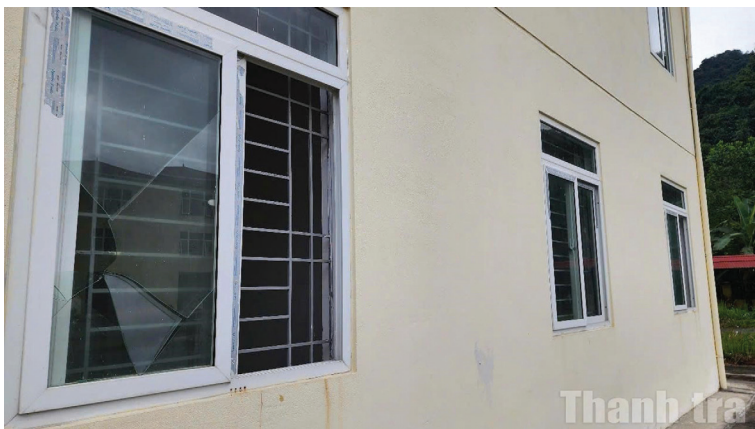
Nhiều hạng mục của công trình đã hoàn thành nhưng xuống cấp hư hỏng. Ảnh: ND
