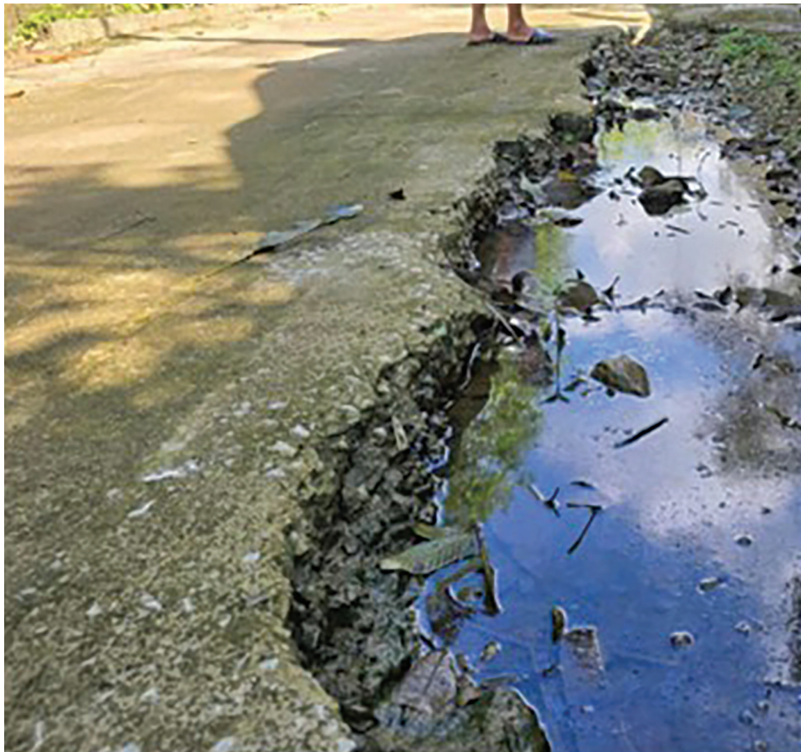
Đường giao thông ở thôn Trà Sơn, mưa thì nước đọng gây nguy hiểm cho người dân mỗi khi tham gia giao thông. Ảnh: Văn Thanh
