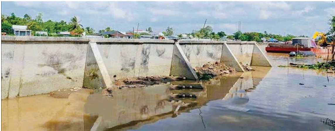
Qua công tác thanh tra tại Dự án Kè chống sạt lở sông Ô Môn giai đoạn 2 tại TP Cần Thơ, Thanh tra Bộ Tài chính phát hiện nhiều tồn tại, hạn chế. Ảnh: MH
